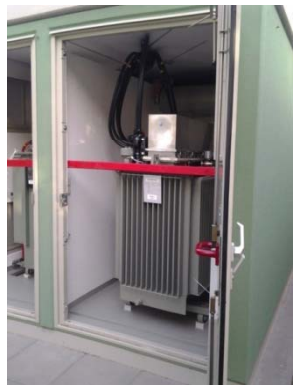
Regelbarer Ortsnetztransformator im e-Home Netz Foto: R. Schnieder
