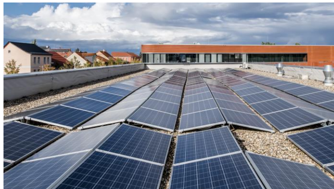
Photovoltaikanlage auf der Neuen Feuerwache Luckenwalde
