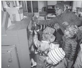
Großes Staunen an der Heizungsanlage
